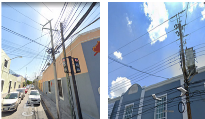
FIGURA 5. INFRAESTRUCTURA ELÉCTRICA EN EL CENTRO HISTÓRICO DE MÉRIDA
